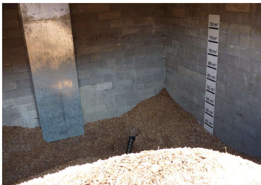
Photo 3 : Vue du silo, celui-ci a une capacité de 120 m 3 et alimente la chaufferie via une vis sans fin.
