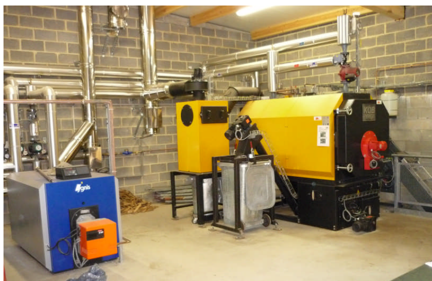
Photo 4 : Vue de la chaufferie.
